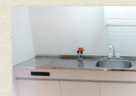
ガスコンロ持込キッチン
